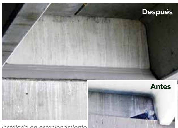
Instalado en estacionamiento
